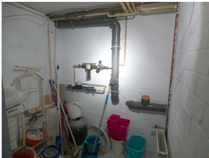
Anschlüsse im Keller
